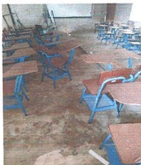
Foto 5: torta de piso a remozar
